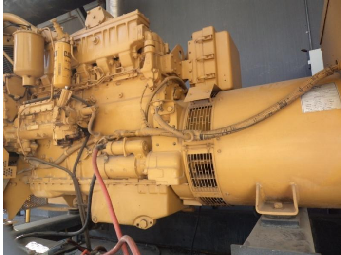
Foto 6. Generador eléctrico del edificio La Previsora.
