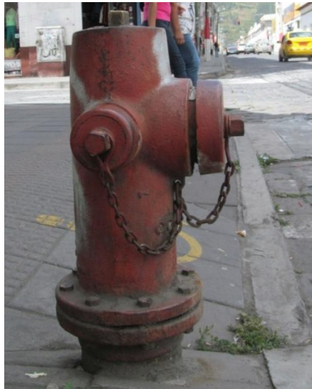
Foto 5. Hidrante externo que puede ser usado en caso de necesidad.
