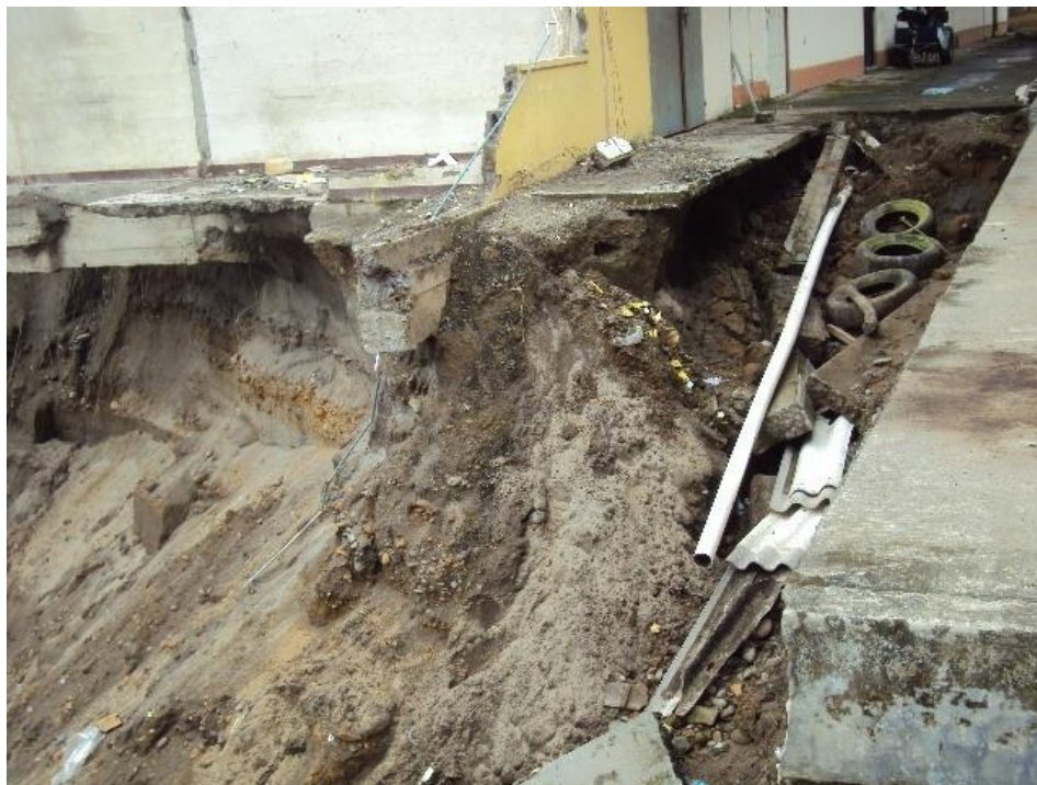
Foto 7 de deslizamiento en centro infantil Lucerito del Saber.
