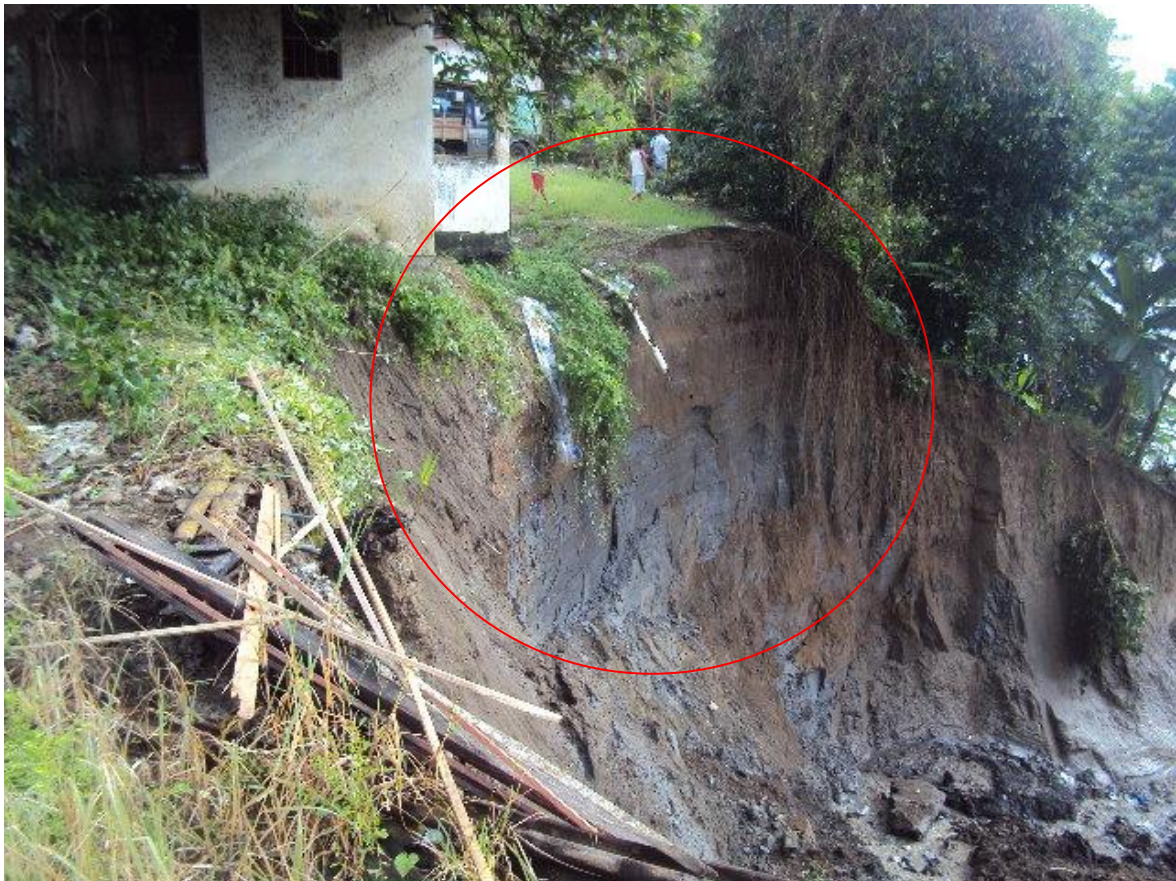
Foto-4: sitio de deslizamientos ocurridos en el Barrio Luz De América cerca al río Blanco
