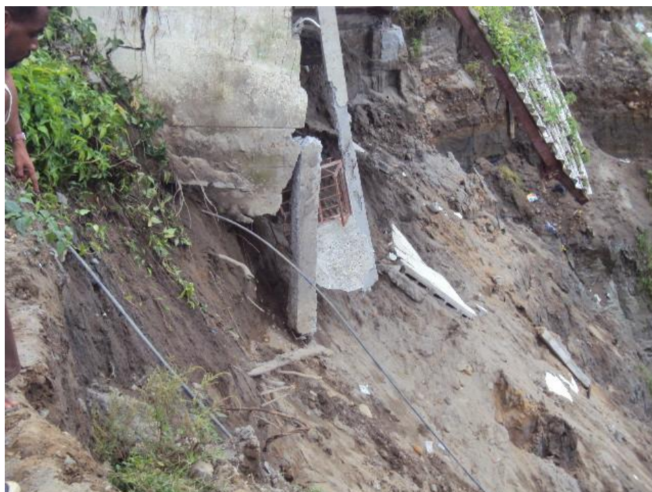
Foto 8 del deslizamiento en propiedad privada.
