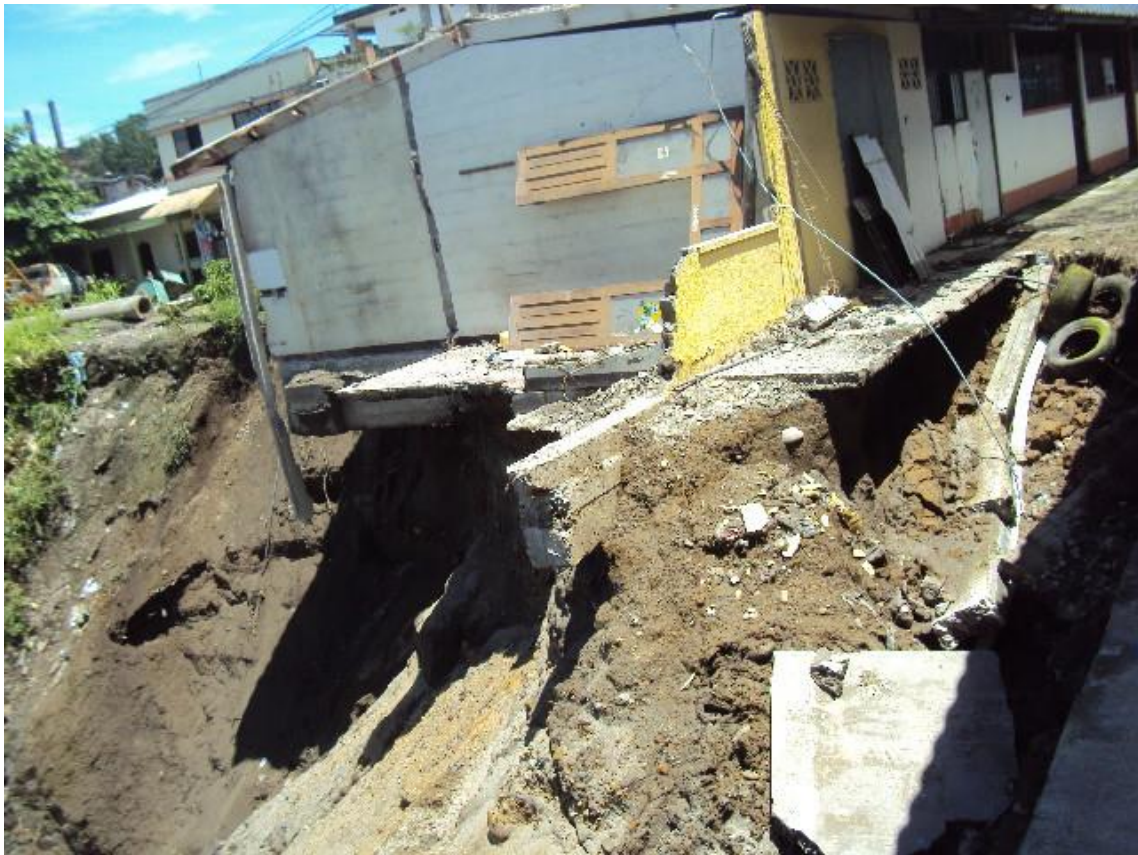
Foto 5 deslizamiento parte sur en la parte central donde se encuentra la escuela.
