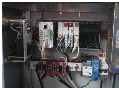
Fotografía # 21 . Red de Comunicaciones
