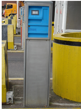
Fotografía # 22 . Sistema de Operaciones de Peaje (SOP)
