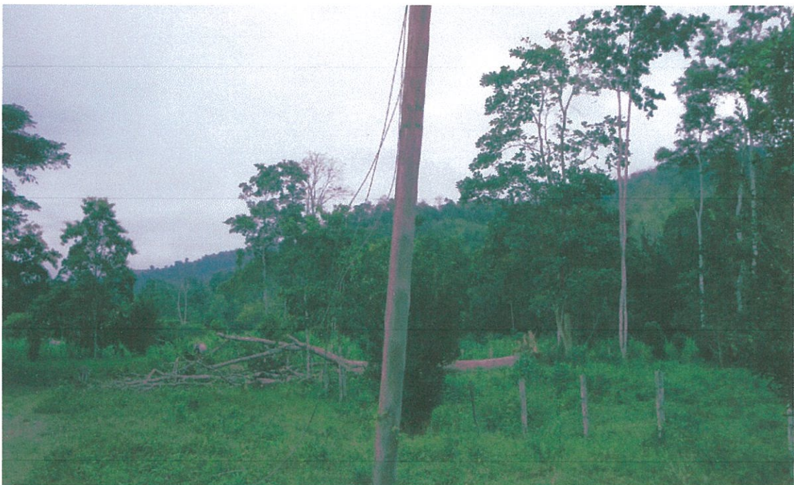
Fotografía 3. Cables de conducción eléctrica en el suelo por caída de árboles
