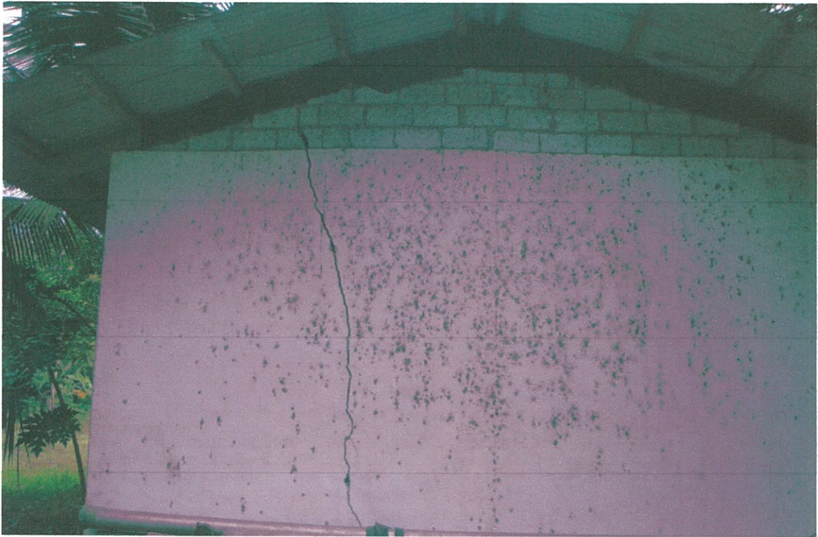
Fotografía 1. Bodega del vivero forestal con paredes agrietadas
