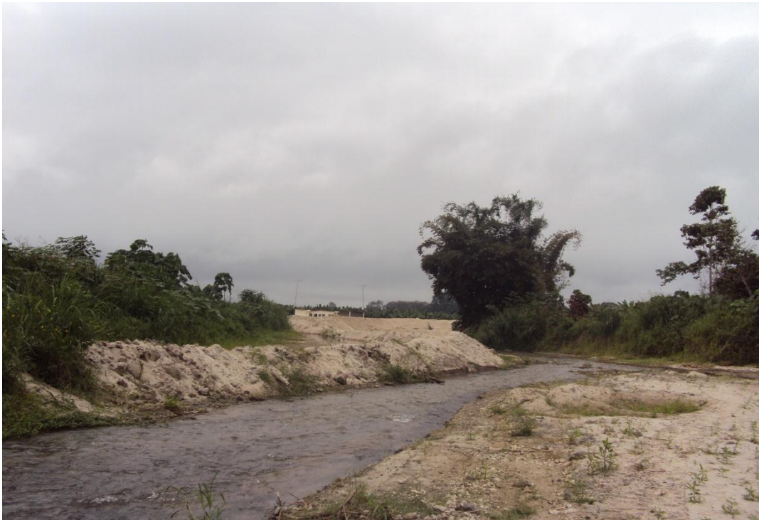
Foto 8. Amontonamiento de tierra fuera de las orillas del río, hacia el interior de éste
