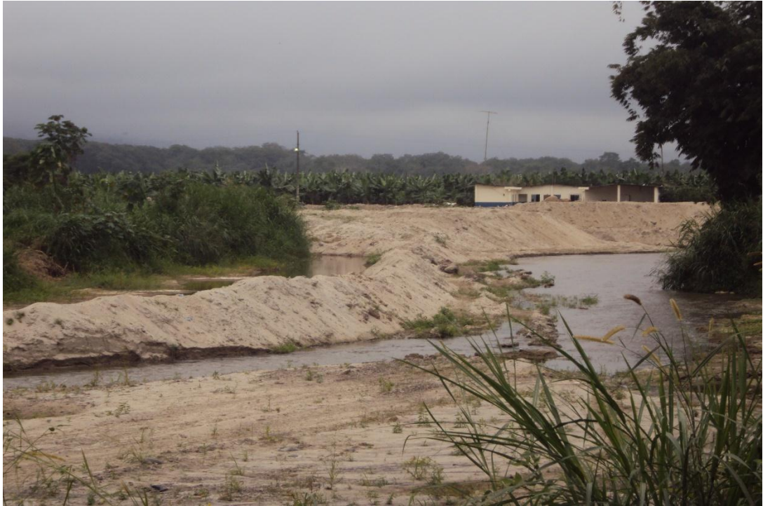
Foto 5. Movimiento de tierras en el cauce mismo del río para realizar una captación de agua y además para conformar una plataforma en una de las propiedades.
