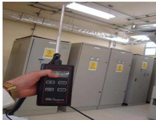
Medición de caudal de aire
