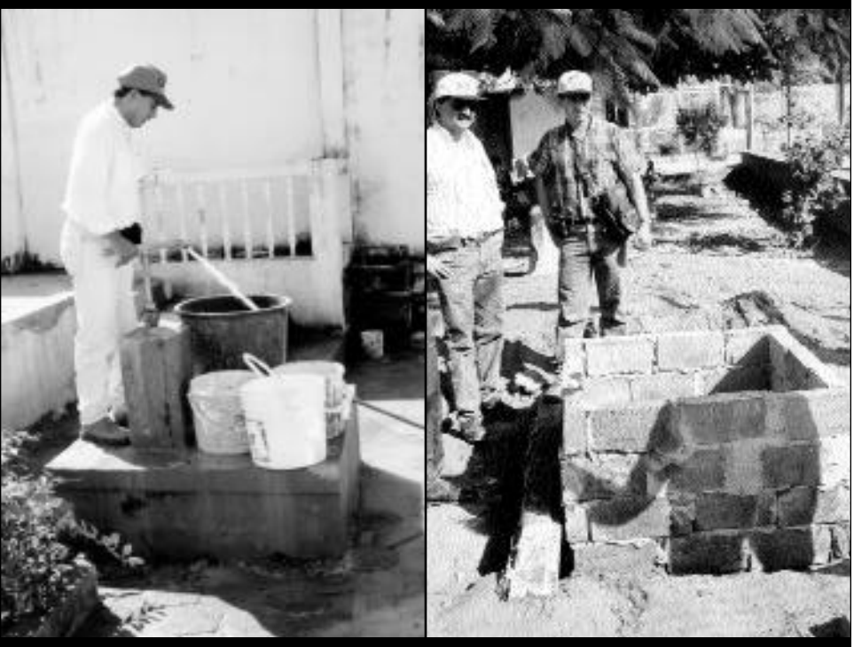
Las bombas flexibles instaladas tienen como características básicas su bajo costo, la tecnología apropiada y la participación comunitaria.
