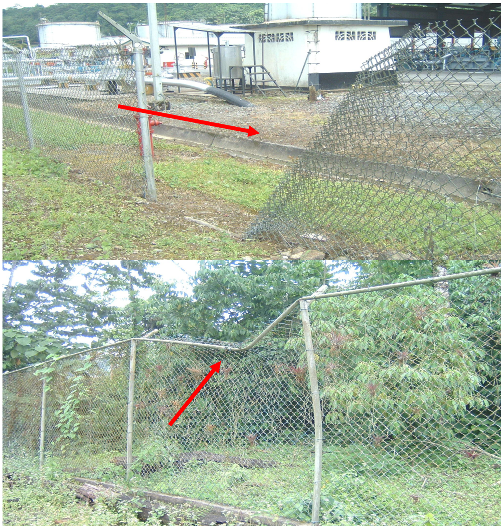
. Fotografías Nos. 27 y 28. Fuente Petrocomercial ESTADO DE LAS MALLAS DE SEGURIDAD
