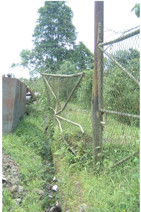
MALLAS EN MAL ESTADO
