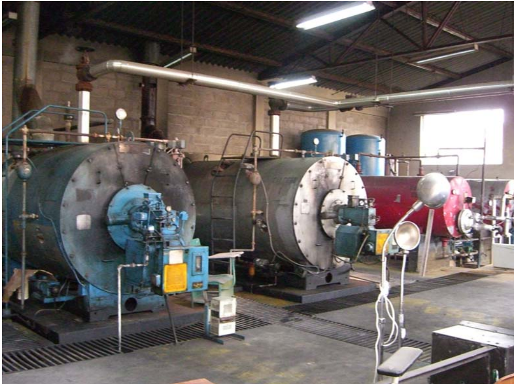
Sala de maquinas del Hospital Pablo Arturo Suárez
